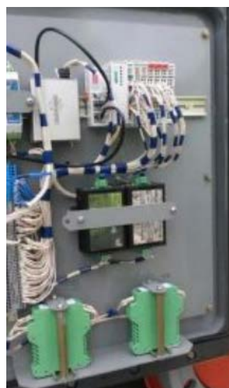
Управление магнитной станции
